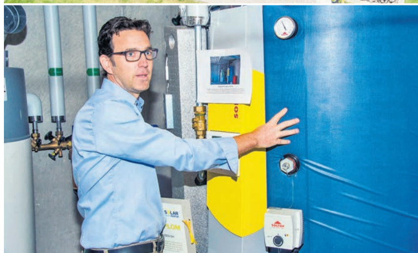
Diese beiden Bilder zeigen das Plus-Energie-Haus der Familie Zollinger in Schaffhausen. Unten zeigt Daniel Zollinger den Wärmespeicher für sein Einfamilienhaus.
